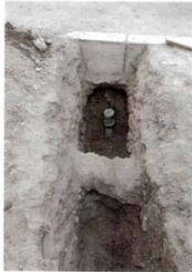
tubería sin accesorios
