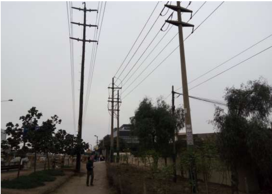
Vista postes de alta y media tension.
